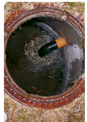
Abb.: Schacht aus Beton
